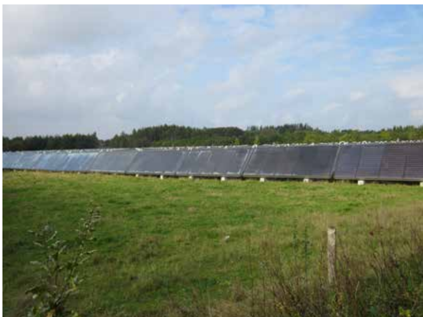
Eksisterende solfanger anlæg
