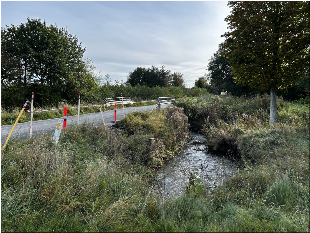
Billede af Lindved Bæk taget fra overkørslen mod udløbet i Bøgballe Bæk. Erosion har medført, at Bøgballevej er ved at styrte i vandløbet.
