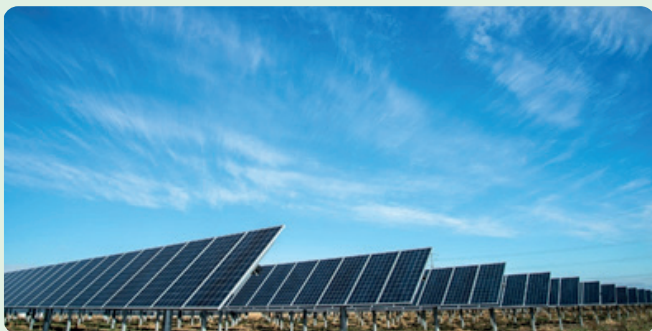
Solcelleanlæg. Foto Hedensted Kommune.
