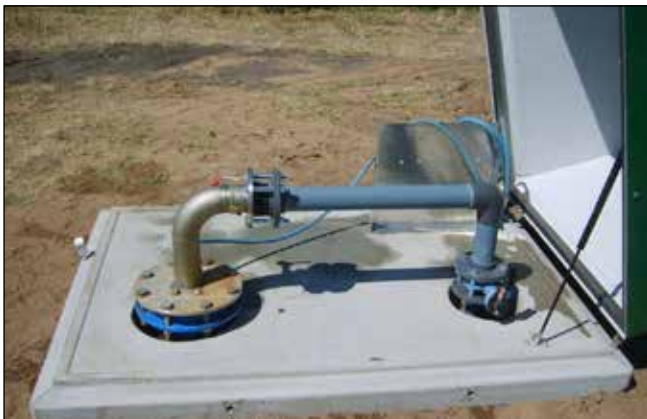
Ny råvandsstation for DGU nr. 117.252.
